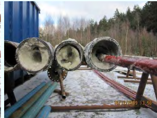
Zustand des Antriebsge- stänges nach Abschluss des PV
